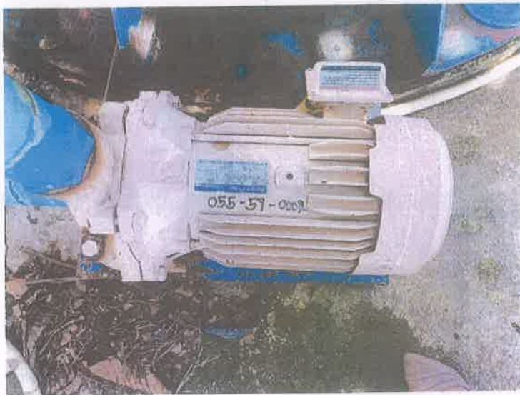
๑๒. เครื่องสูบน้ำแบบหอยโข่ง ชนิดมอเตอร์ หมายเลขครุภัณฑ์ ๐๕๕-๕๗-๐๐๐๗
